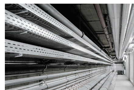
Kabelové žlaby, potrubní instalace
